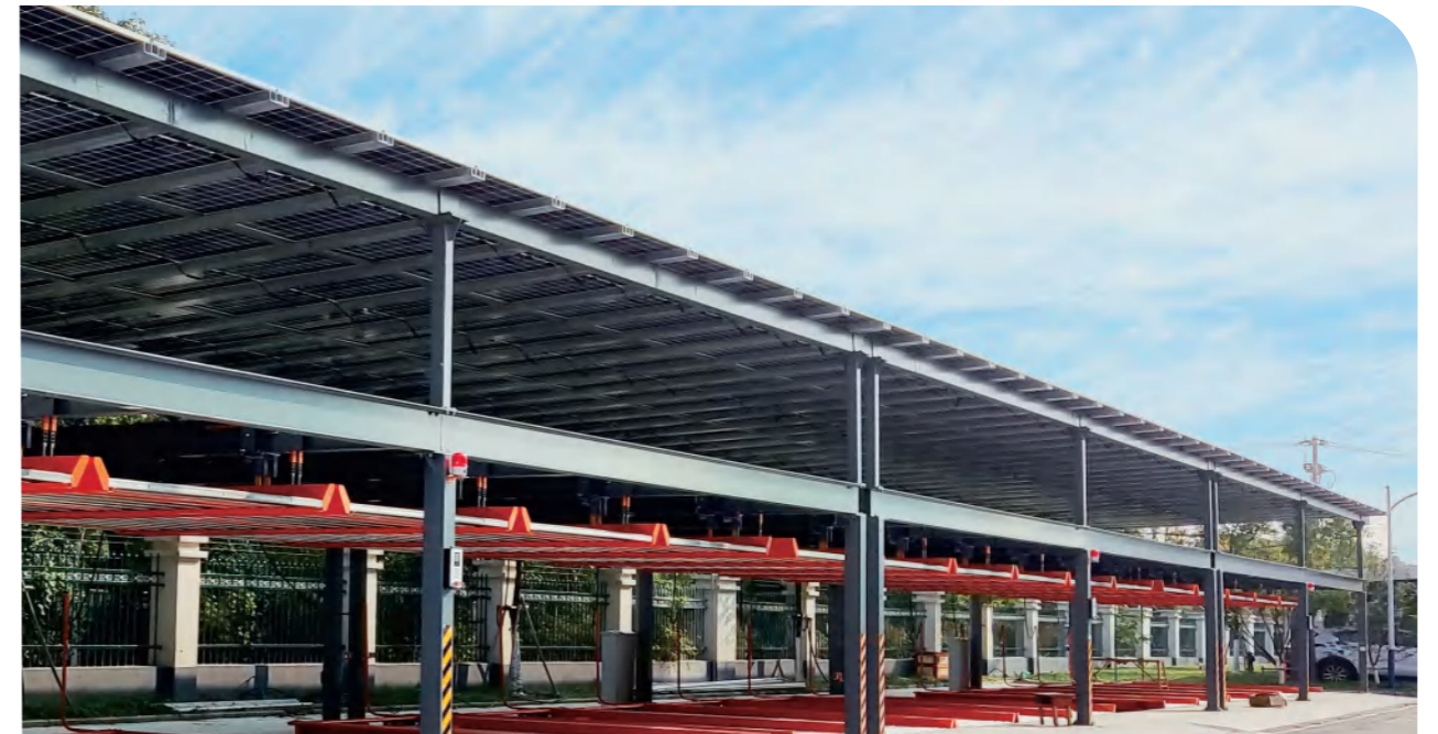
双层车库:光伏车棚
