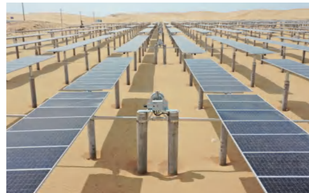
项目地: 中国·内蒙古达拉特旗 容量: 332MW 解决方案: 固定可调+平单轴跟踪系统
